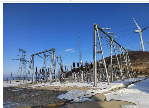
110kV 配电装置区
