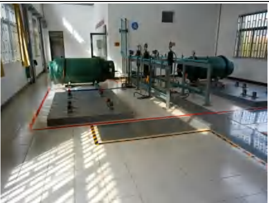
净水厂液氯罐风险防范措施
