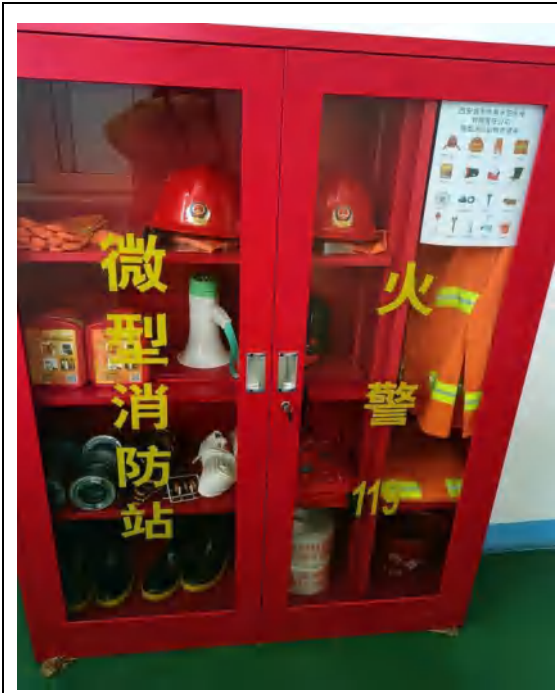
二塬子电站灭火装置
