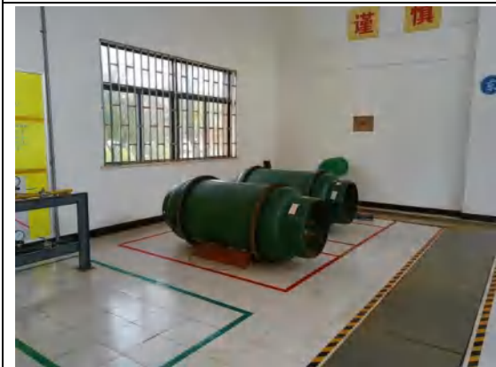
净水厂液氯罐风险防范措施
