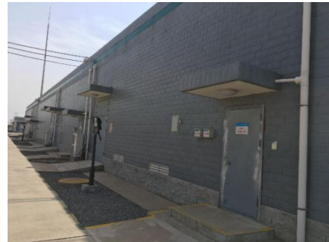
330kV 升压站 35kV 配电室
