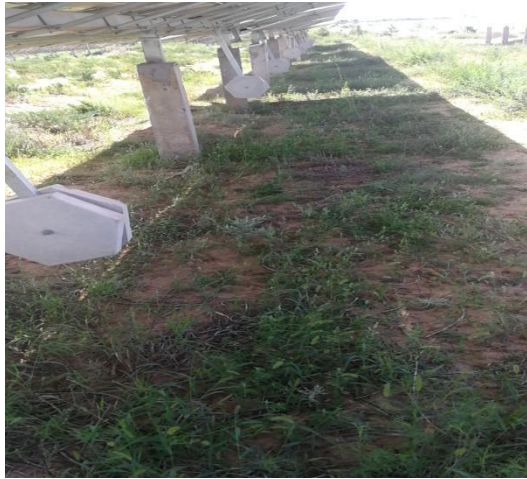
太阳光伏板下植被绿化
