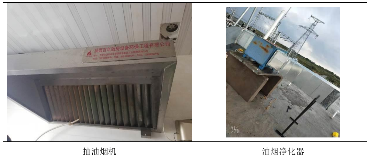
图 4-12 运营期大气污染控制措施照片
