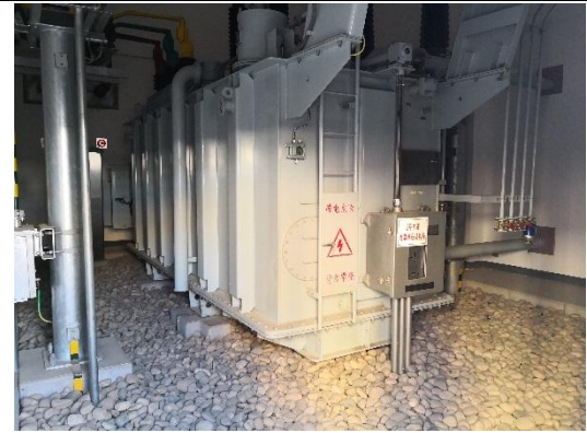
2#主变及事故油坑
