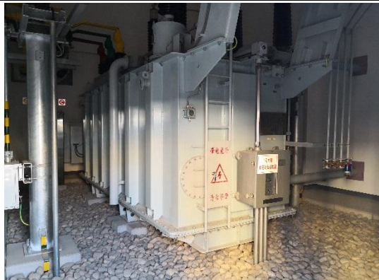
1#主变及事故油坑
