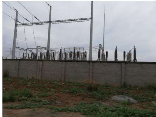
空港变电缆出线间隔
