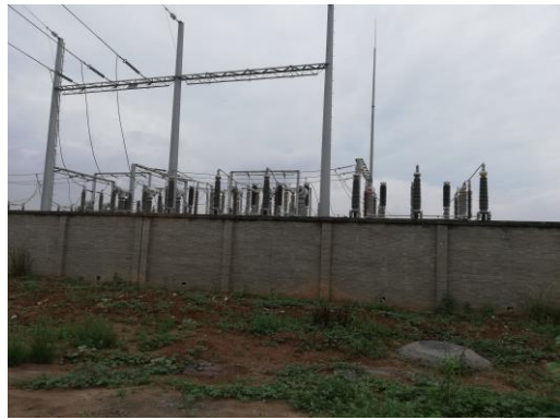
空港变电缆出线间隔
