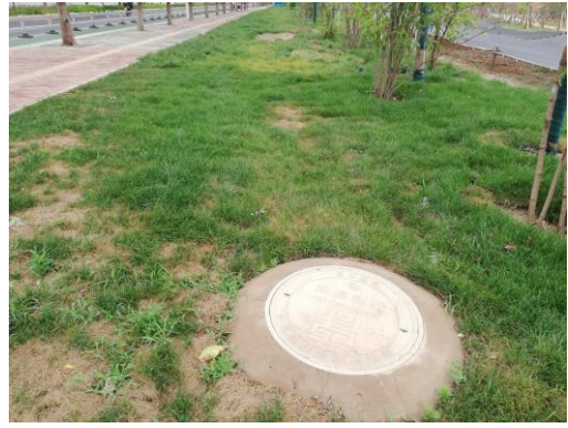
电缆敷设现状 2
