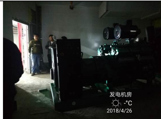
发电机房及吸声墙面
