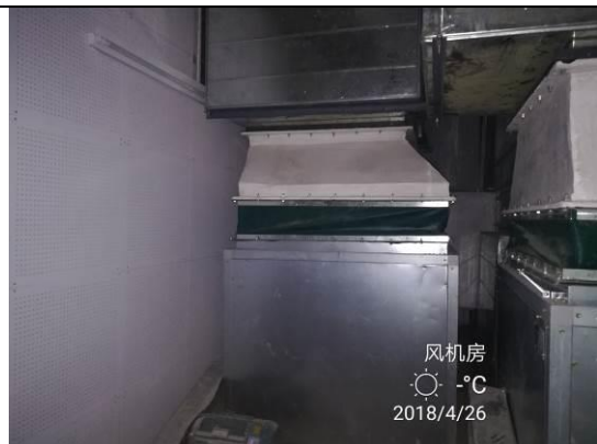
地下风机房及吸声墙面、通风管道软管连接
