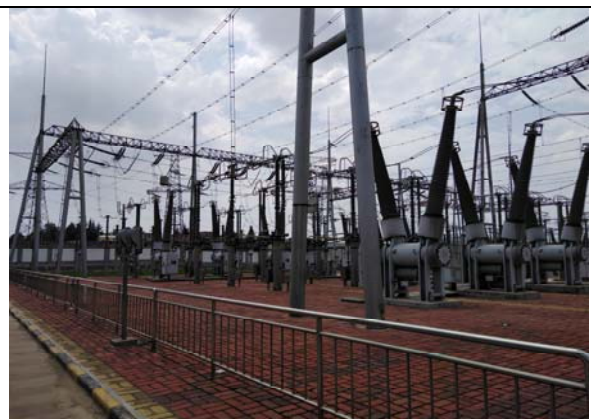
330kV 出线间隔
